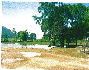
Đường cấp phối đá dăm nối từ QL1A vào nhà máy giấy, ngang qua lăng Bà Triệu hiện bị xuống cấp - lún sụt nhiều chỗ. Động nước và lấy lợi khi mưa; bụi khi nắng và khô
